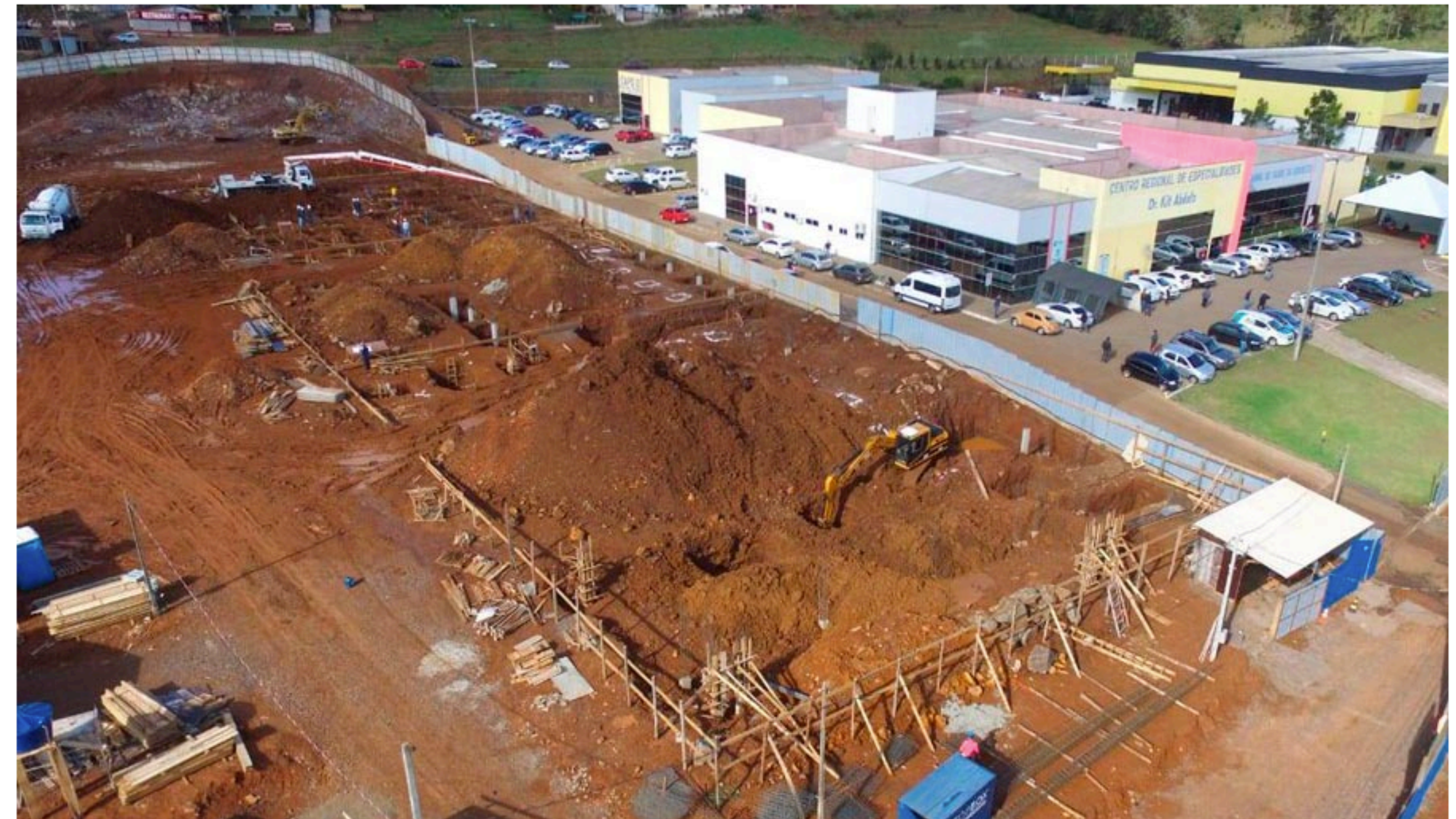
A Construtora Sudoeste está construindo o Hospital Geral Intermunicipal no Bairro Água Branca. A conclusão da obra deve ocorrer num prazo de 24 meses. O hospital vai atender os 27 municípios da microrregião. Fotos: Assessoria
